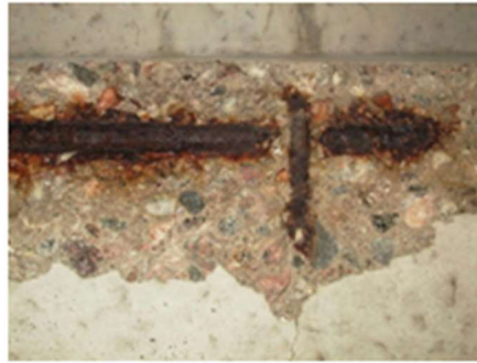
Exempel på skadad balkong. OBS! Annat objekt!
